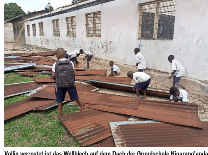
Völlig verrostet ist das Wellblech auf dem Dach der Grundschule Kiparang'anda. Es muss erneuert werden.
