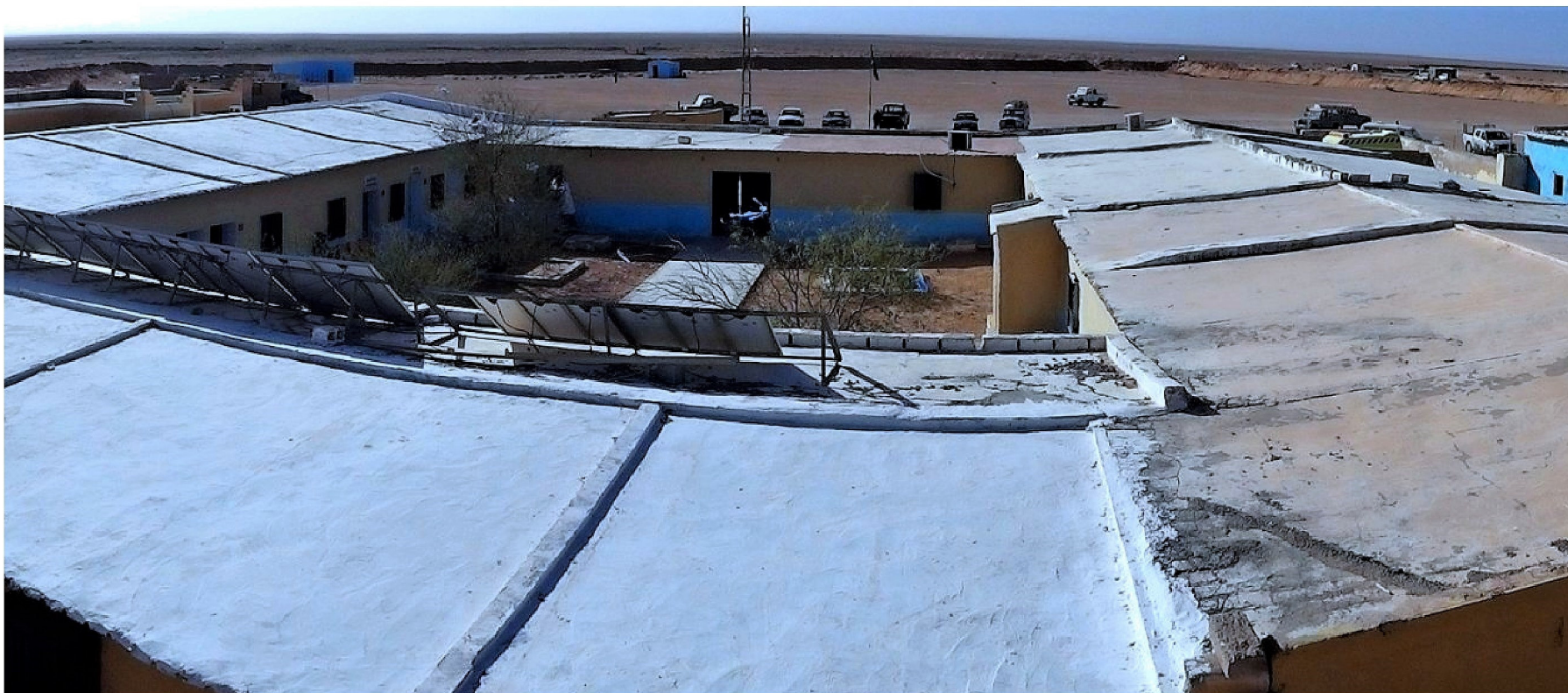
Das Krankenhaus in Laayun erhielt ein neues Dach, die Wände wurden trockengelegt und die Patientenzimmer sind neu gestrichen worden.
