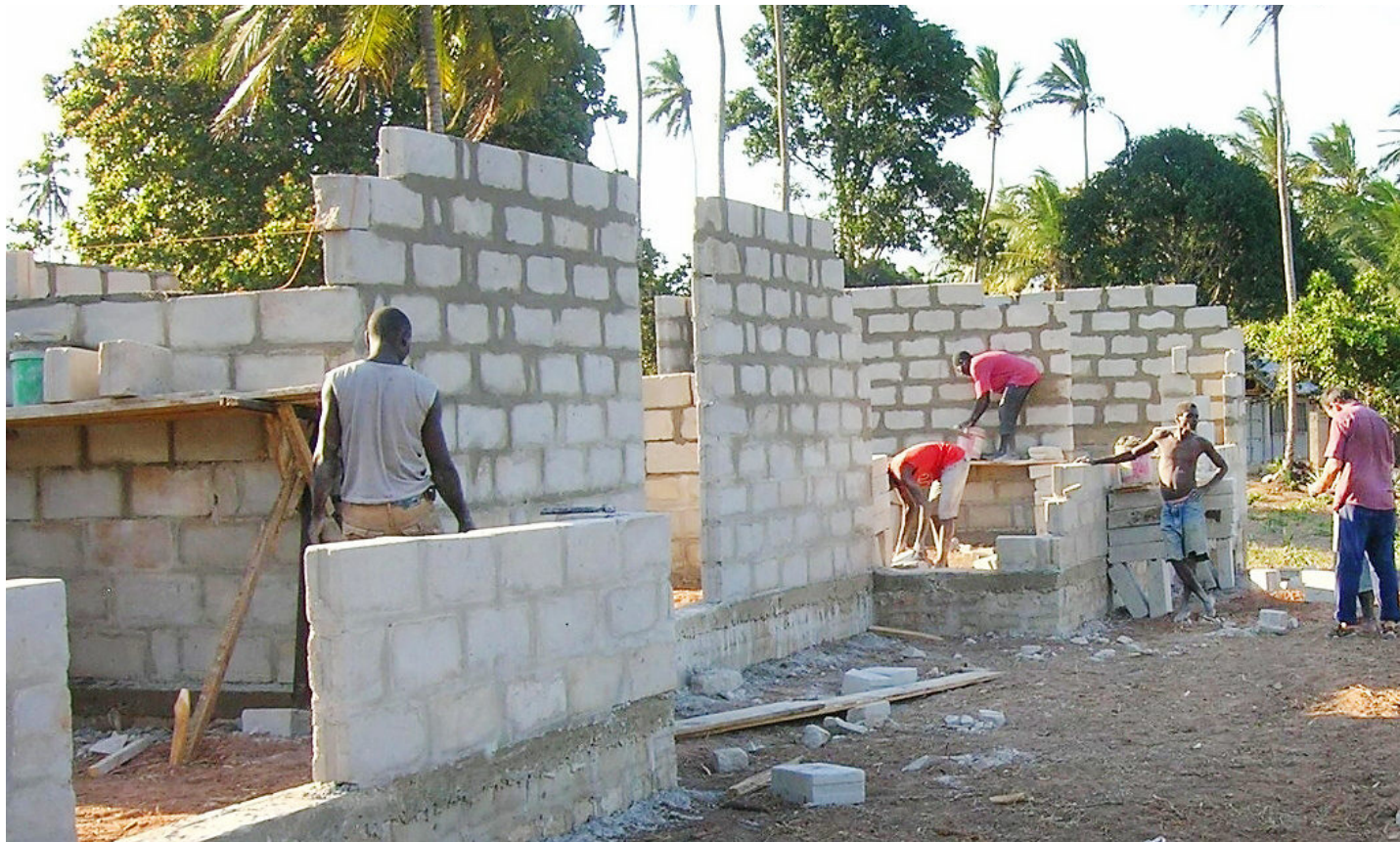
Als nach „Hammelburger Manier“ gebaut wurde, war schon nach wenigen Tagen ein sichtbares Ergebnis vorzuweisen. Vier Wochen lang halfen Uwe Tobaben, Elmar Iff und Thomas Stöth bei der Errichtung des Kindergartens mit.
