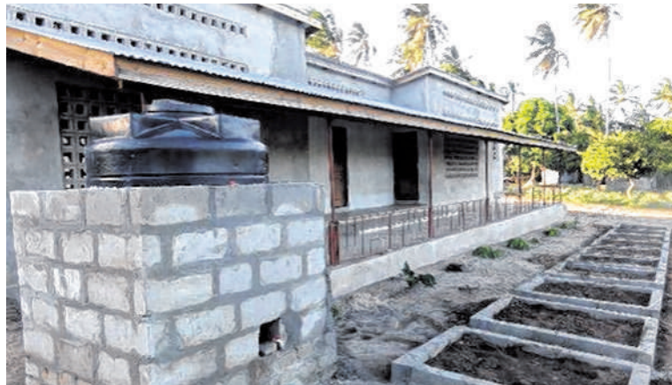
Zufrieden ist Uwe Tobaben (Foto oben) mit dem Baufortschritt an Kindergarten und Schule in Kiparang'anda.
